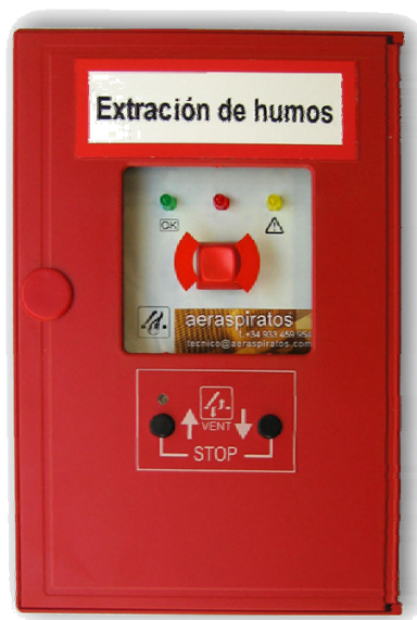
Cuadro de control
